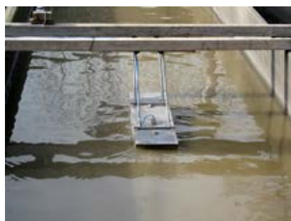
Flödesmätning uppifrån och ned i avlopp med kraftig sedimentering
